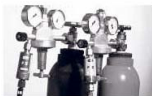
Figura 6: posto di saldatura a gas con riduttori di pressione, valvole antiriflusso del gas e dispositivo di arresto della fiamma.
